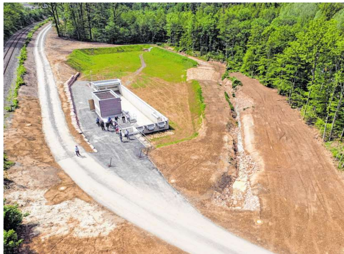
Von oben werden die Dimensionen des Regenüberlaufbeckens 1 deutlich. An das Becken ist eine kanalisierte Stadtfläche von fast 17 Hektar angeschlossen.
